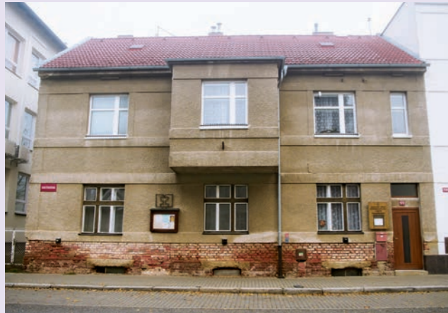
Das sanierungsbedürftige Gemeindehaus in Havlíčkův Brod
